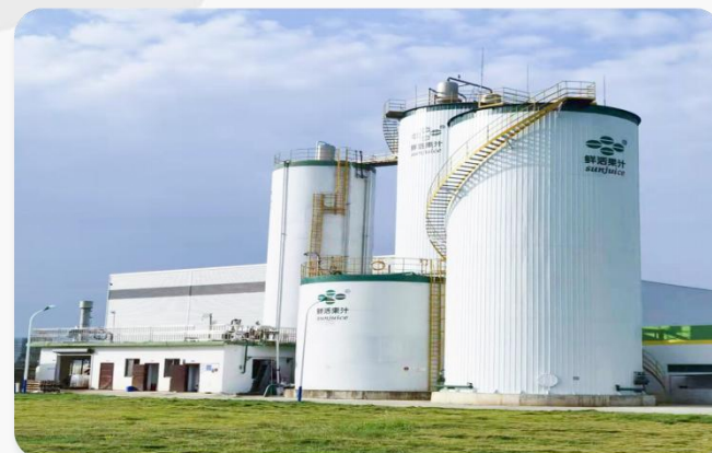
广东鲜活果汁生物科技有限公司废水处理工程 处理水量: 150T/D 处理工艺: DIAB工艺
